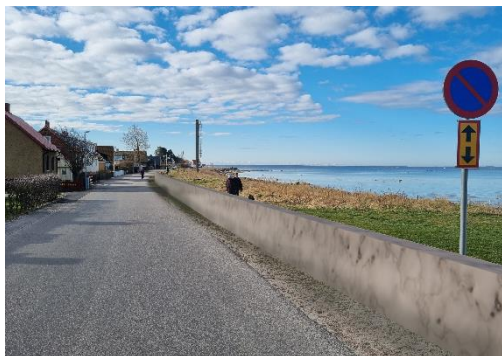
Läge A – Eventuell förlängning av skyddsmur söderut där skyddsmuren ansluter till befintliga höjder mellan + 2,1 och +2,3 m.ö.h. RH 2000. Detta innebär en mur från befintlig marknivå till en höjd på ca 1,4–1,2 meter år 2150.
